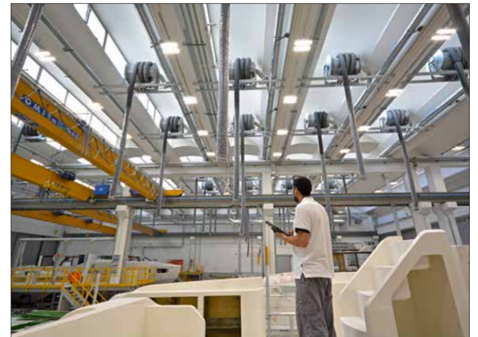
Dans le hall de montage, les enrouleurs fixés au plafond sont des gaines d'aération que les techniciens peuvent placer n'importe où à l'intérieur de la coque.
