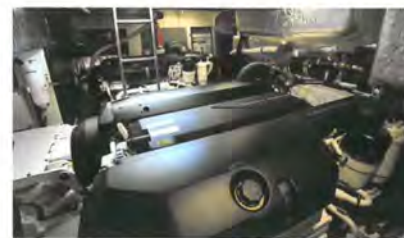
エンジンルーム。2基のD8-IPS700の間、写真左端にシーキーパー(Seakeeper)製のジャイロスタビライザーが見えますが、大きさからするとSeakeeper 5でしょうか。意外に軽量級のものだったようですが、効果は十分にわかりました
